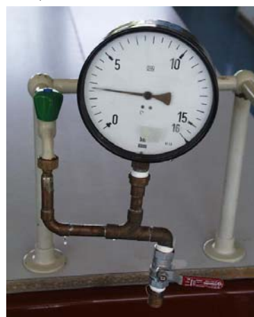
Abb. 2: Druck in der Wasserleitung
